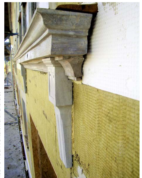
(4) Fensterbankdetail Brauereigasthof Autenried: Die historischen Gesimse wurden vor der Dämmmaßnahme abgenommen und anschließend wieder befestigt.
